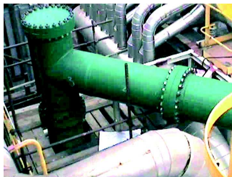
Kolektor poziomy z wadami wykonawczymi. Termogram wykonany kilka miesięcy po remoncie
