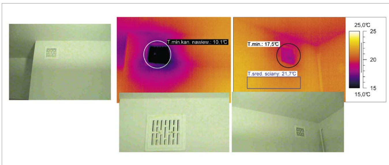
Rys. 4. Na termogramach widoczne są kratki wentylacyjne w pomieszczeniu. Jedna z nich jest silnie wychłodzona, co świadczy o istnieniu nawiewu, zamiast wywiewu (odwrócenie ciągu). Termogramy wykonano w mieszkaniu na ostatnim, piątym piętrze budynku – w takich mieszkaniach długość kanałów wentylacyjnych jest mała i najłatwiej tam o odwrócenie ciągu. Wychłodzenie kanału powoduje, że przywrócenie normalnego, wyciągowego charakteru jest bardzo trudne, zwłaszcza przy słabym nawiewie przez szczelne okna i drzwi.
